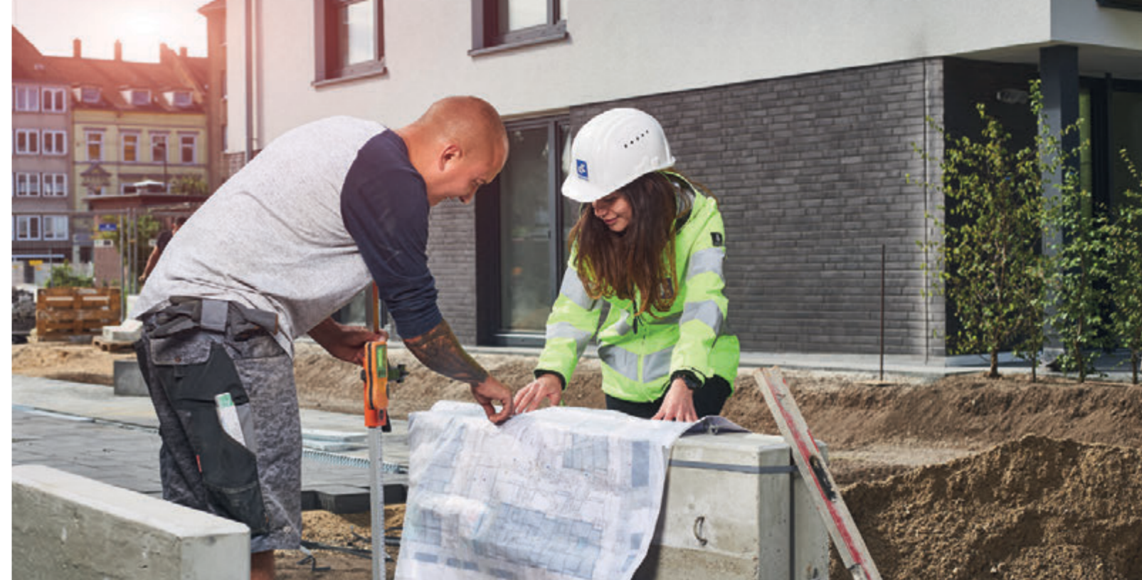
■ Bauleiterin Dilek Erginbas mit Garten- und Landschaftsbauer Filip Dabrowski (Gartenhof Küsters GmbH, Neuss) auf der DEKO-Baustelle Mindener Straße in Düsseldorf
